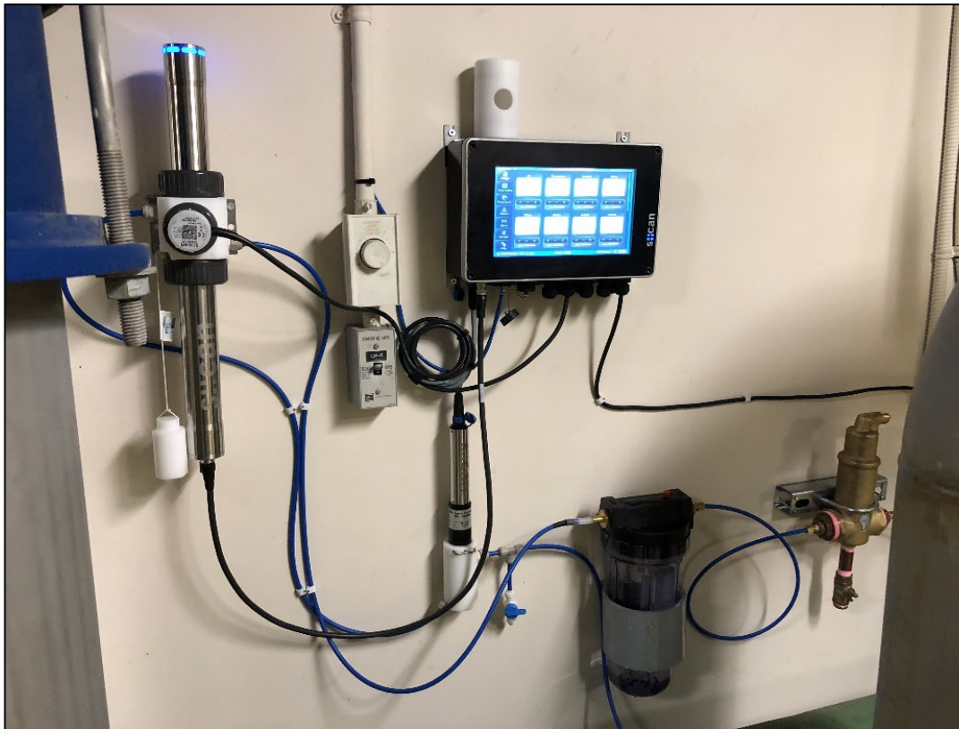
Raw Water S::CAN
